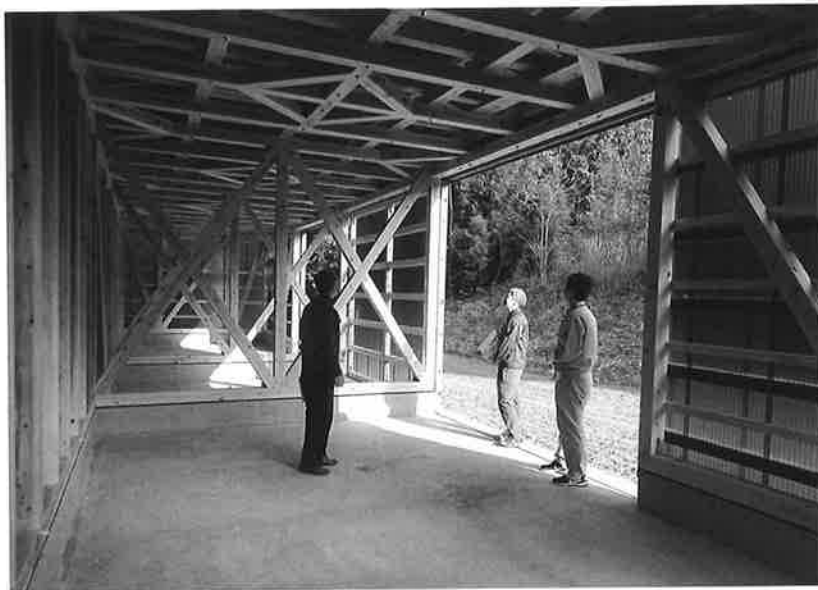
美波町木材備蓄倉庫 全てが四寸角の 柱材でできている
