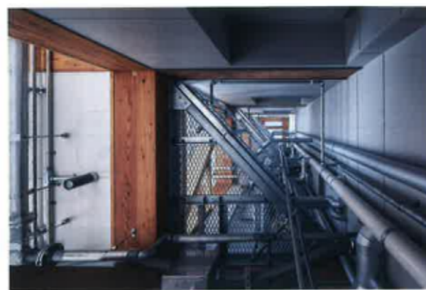
「エコシャフト」見上げ。配管・給湯器等を外部で集約し、メンテナンス性を高めるとともに、浴室や居室に換気・採光を取り入れる
