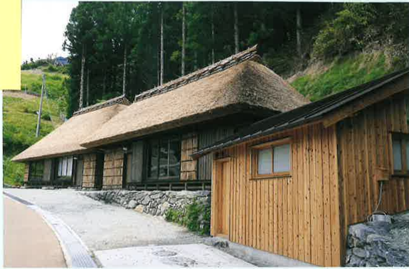
朽ち果てていた古民家を復元工事が完成し、「晴耕雨読」と名づけられた連棟の古民家。復原された古民家は八棟を数え、宿泊施設として活用されている。
